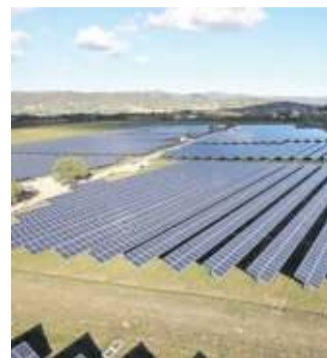
Un impianto fotovoltaico
